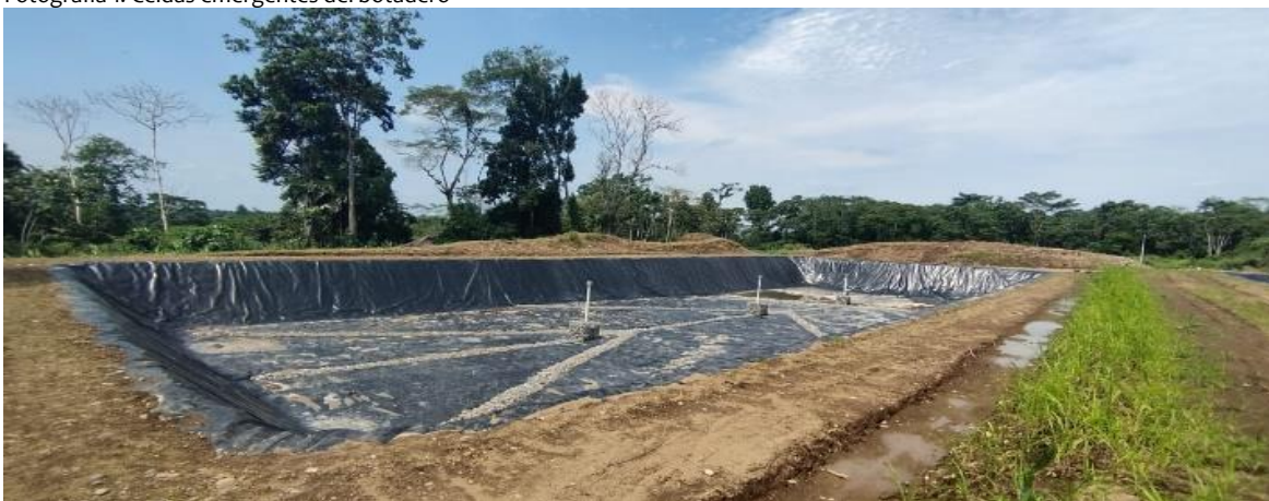
Fotografía 1. Celdas emergentes del botadero
